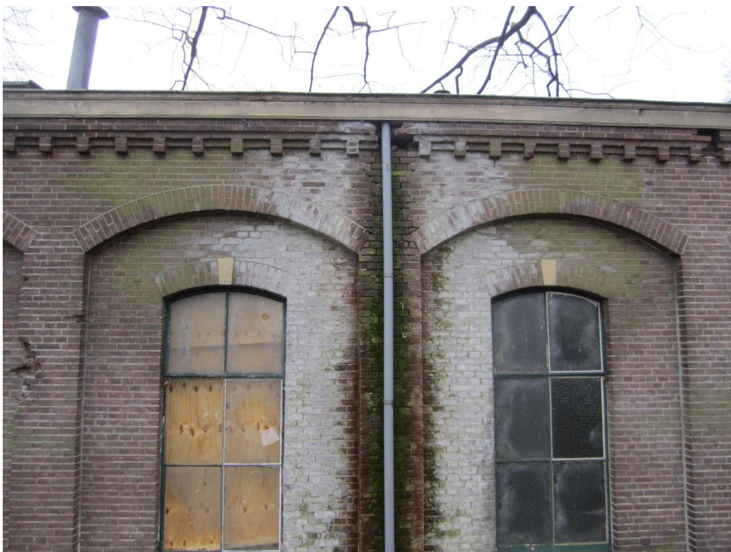
Foto 14. Nog een opening van het exterieur aan de bovenzijde van de regenpijp.
