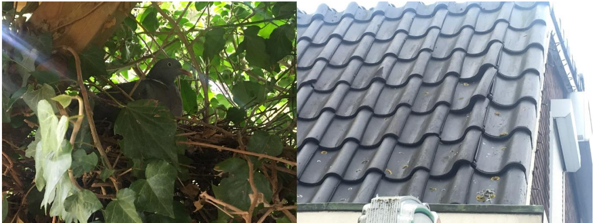
Foto links; nest houtduif in Hedera begroeiing. Foto rechts; de dakpannen, van het restaurant, sluiten niet goed op elkaar aan.
