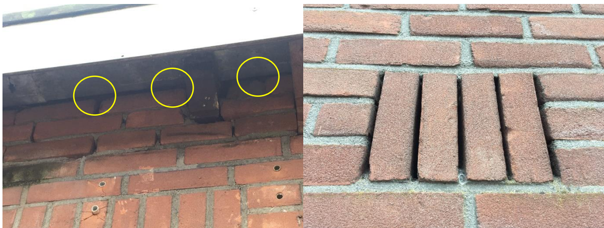
Foto links; Er zijn kieren vastgesteld tussen betimmering van het dak overstek en de buitengevels van het restaurant (gele cirkels). Foto rechts; er zijn ventilatieopeningen vastgesteld in de buitengevels van de bedrijfswoning.
