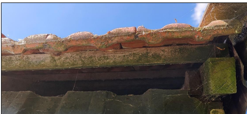
Dakbeschot ontbreekt in de te slopen schuur.
