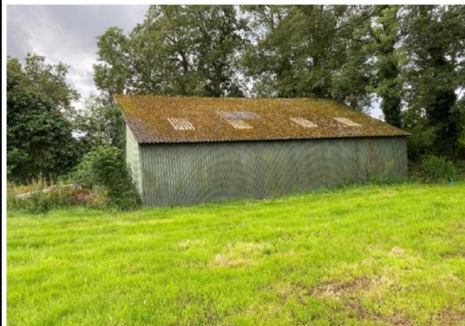
figuur 3: asbestdak van de kapschuur zonder dakgoot
