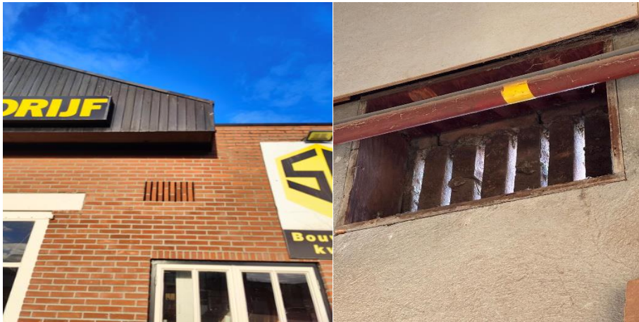
Foto links; ventilatieopeningen in de buitengevels van het bedrijfsgebouw. Foto rechts; ventilatieopening is rondom dichtgetimmerd en biedt geen toegang tot de spouwmuur.
