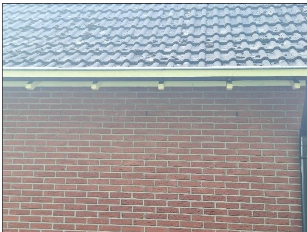
De aangetroffen open stootvoegen zijn aan de smalle kant voor vleermuizen en zitten vol met spinrag.
