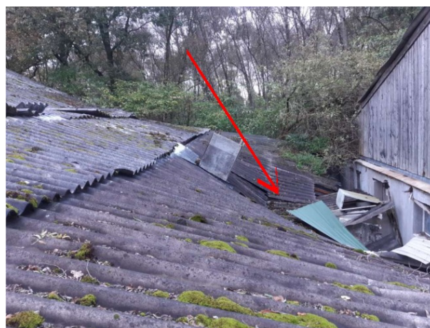
Dak gedeeltelijk ingestort bron 3
