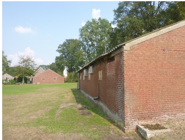
Druppelzone noordzijde schuur
