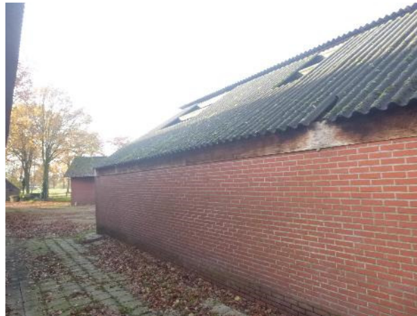
Beschadigd dak schuur watert af op tegels
