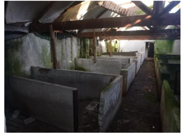
Leegstaande deel schuur zonder dak
