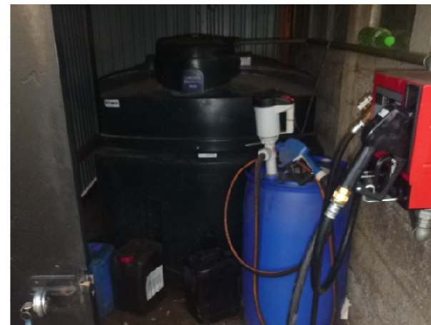
Bovengrondse dieseltank in overkapping
