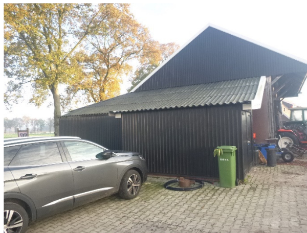
Overkapping met dieseltank
