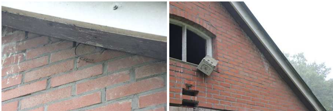
Sporen die duiden op de aanwezigheid van vogelnesten over het dakvlak.
