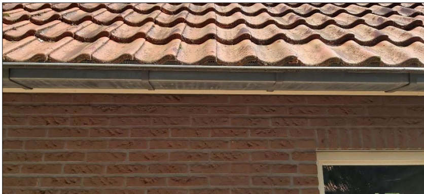
Vogelschroot onder de eerste rij dakpannen.
