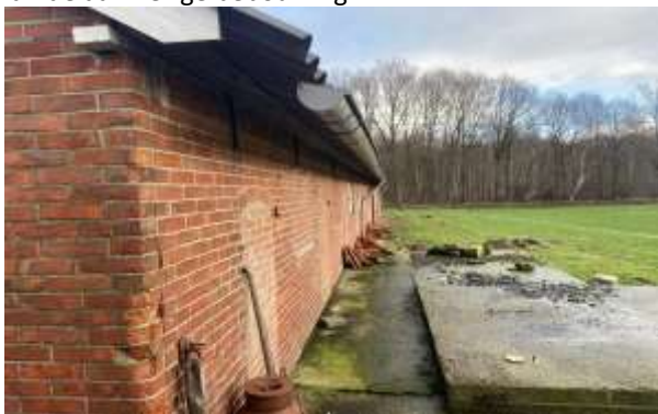
Figuur 2: Dakgoot bebouwing
