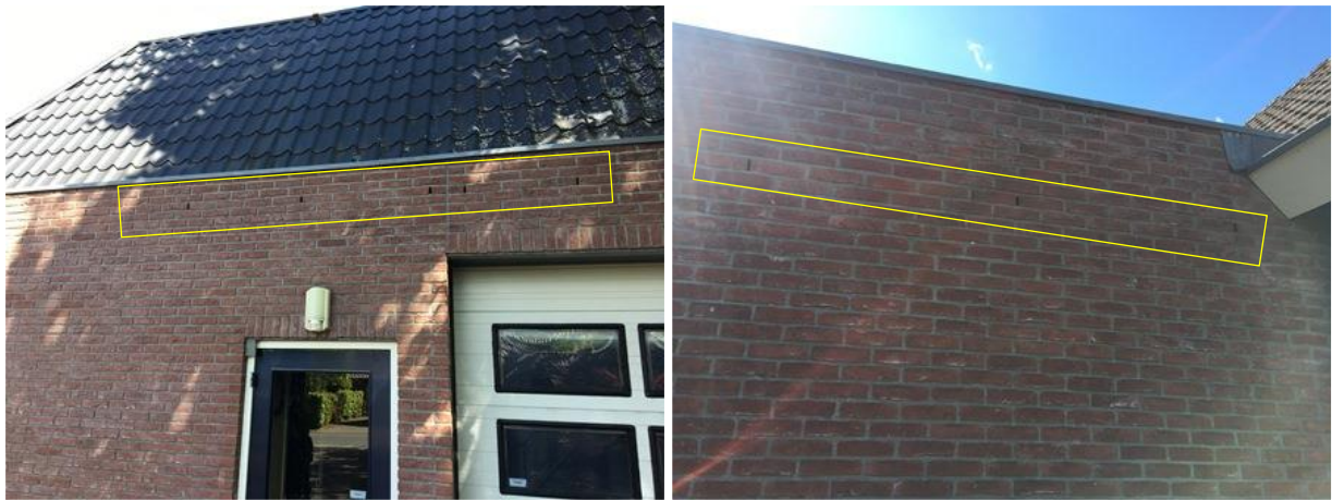
Open stootvoegen in de buitengevel aan verschillende zijgevels van het bedrijfspand. Vleermuizen kunnen de spouw betreden via deze openingen.
