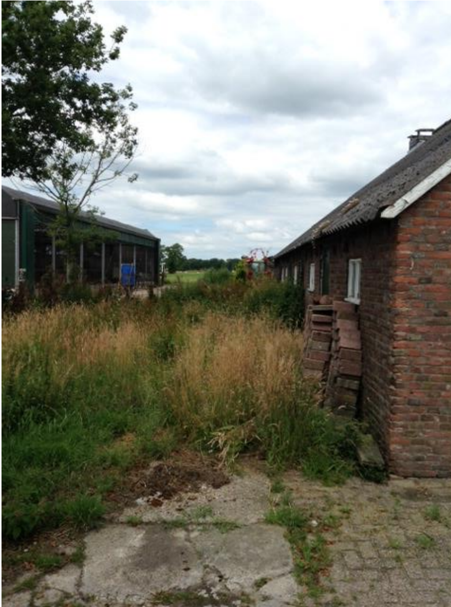
Foto 2: asbestverdacht dak stal zonder dakgoot
