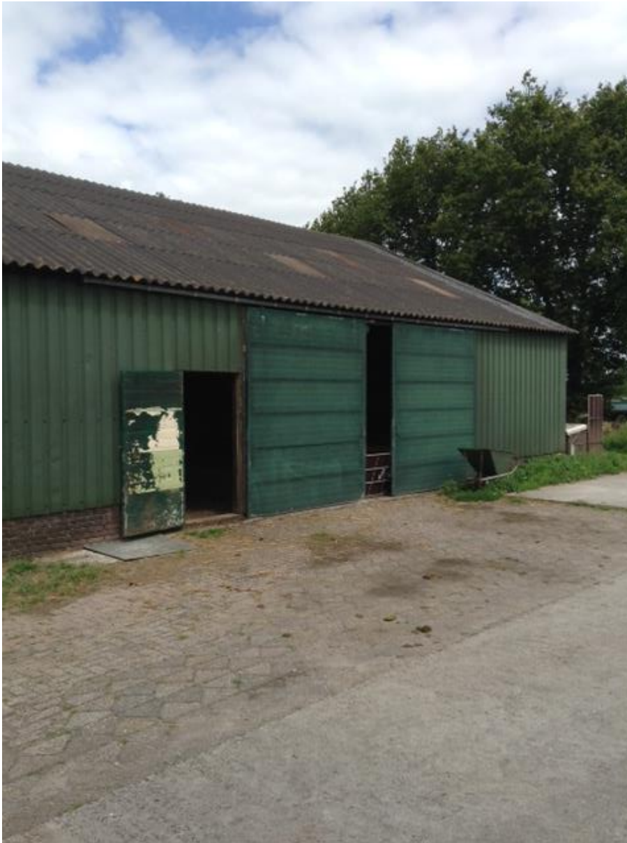
Foto 3: asbestverdacht dak stal zonder dakgoot
