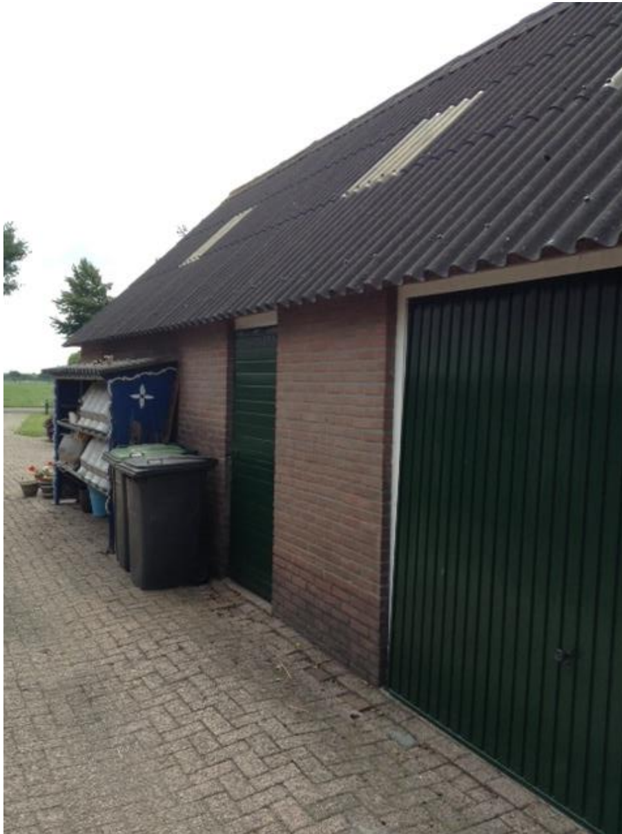
Foto 1: asbestverdacht dak schuur zonder dakgoot
