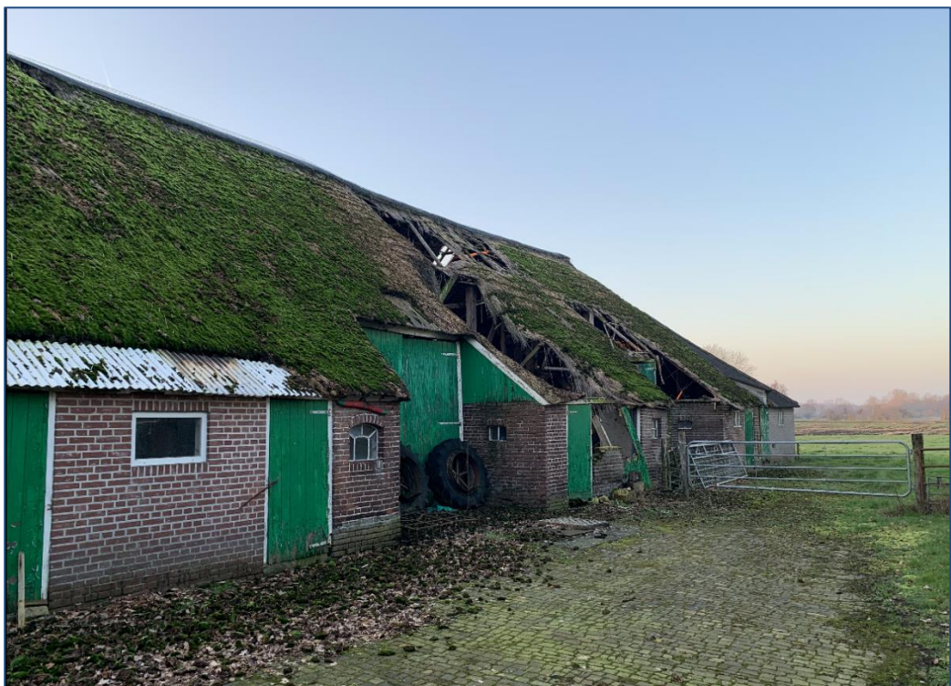
Fig. 4.4: Weergave van de voormalige boerderij dat voor de sloop al deels op instorten stond.
