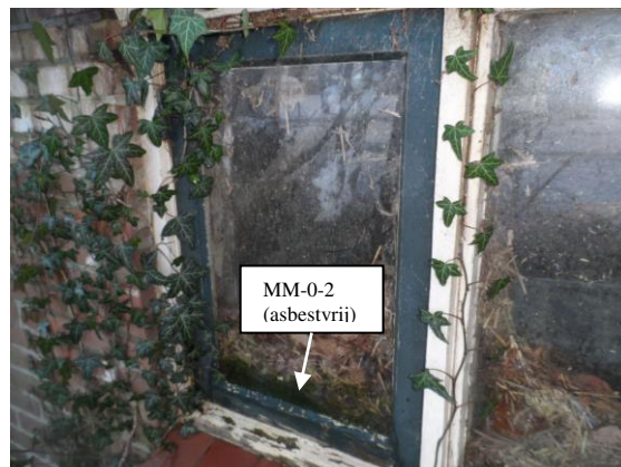
Foto 2: Asbestvrije stopverf in houten ramen in buitengevels van boerderij.
