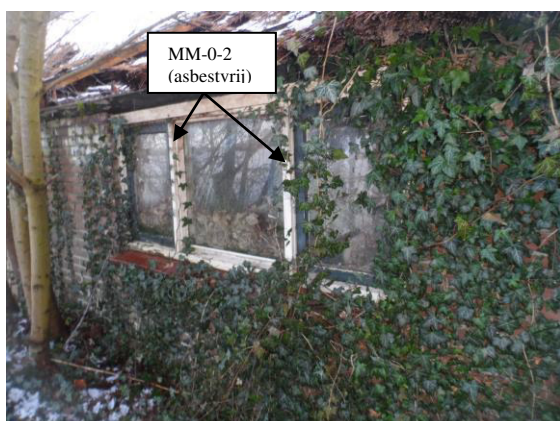
Foto 3: Asbestvrije stopverf stalen ramen in buitengevels van boerderij. (zie foto 2)
