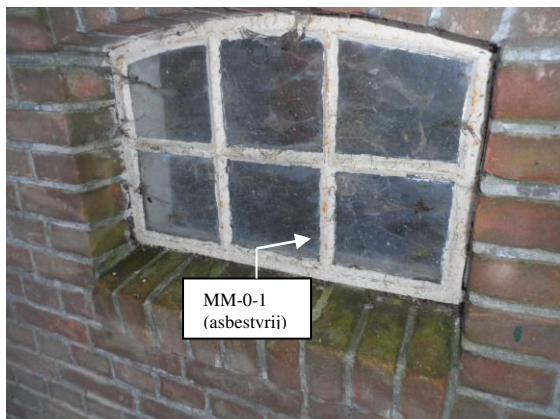
Foto 1: Asbestvrije stopverf stalen ramen in buitengevels van boerderij
