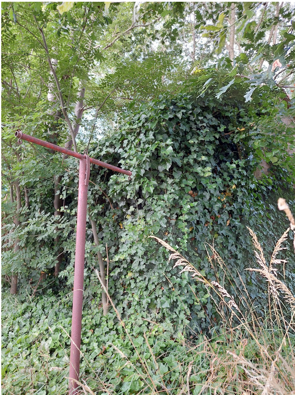
Afbeelding 8: Klimopbegroeiing aan het gebouw op de Dekkersweg. Situatie op 18 juli 2022.
