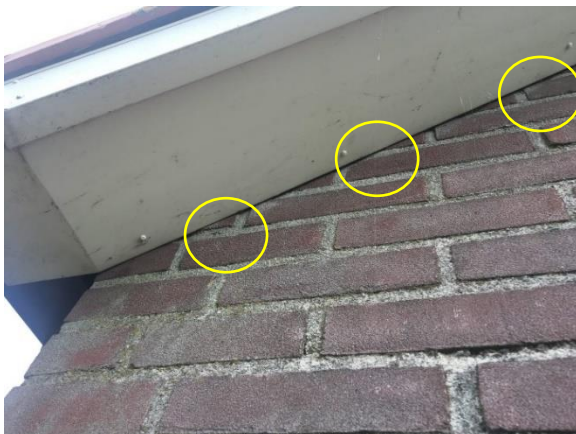
Er zijn kieren vastgesteld tussen de betimmering van de overstek van het dak en het metselwerk van de woonboerderij (gele cirkels).
