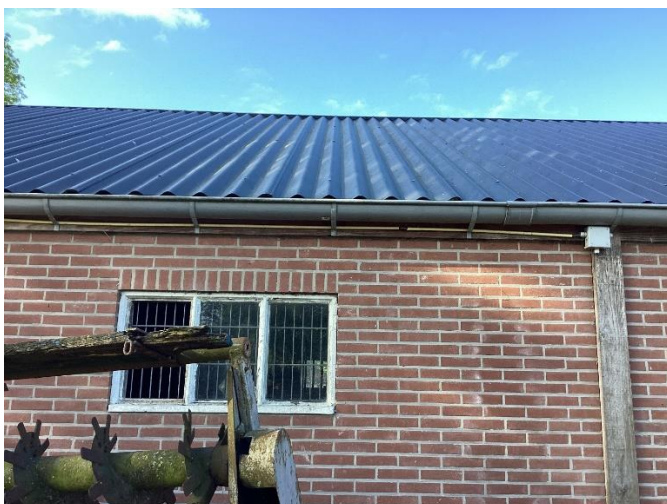
Figuur 4: Voor vleermuizen ongeschikte dubbelsteens muur en golfplaten dak.
