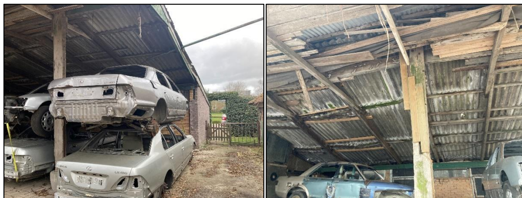
Figuur 2.3 (links): De oostzijde van de kapschuur. De kapschuur heeft een golfplaten dak zonder isolatie. Momenteel wordt de kapschuur gebruikt als opslag voor auto's en caravans; Figuur 2.4 (rechts): Onder het dak van de kapschuur is opslag van materialen, hier zijn geen sporen van de aanwezigheid van vogels gezien, zoals nesten, nestmateriaal, poepsporen of prooiresten.
