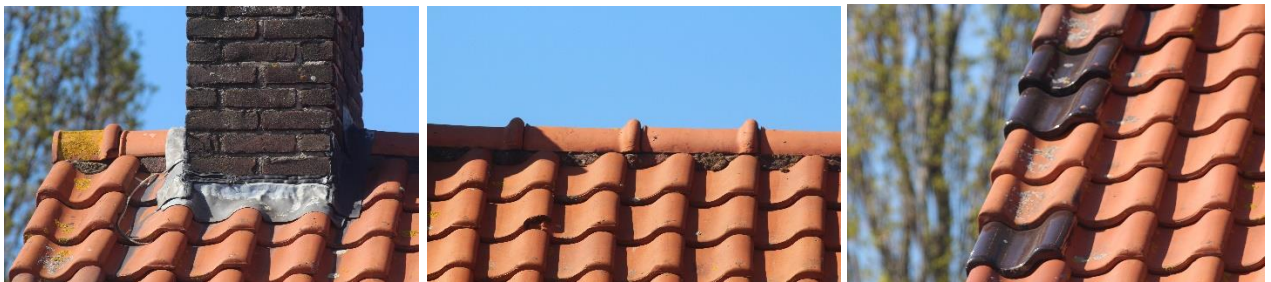
Figuur 7. Inspectie pannendak Eikenlaan 12.
