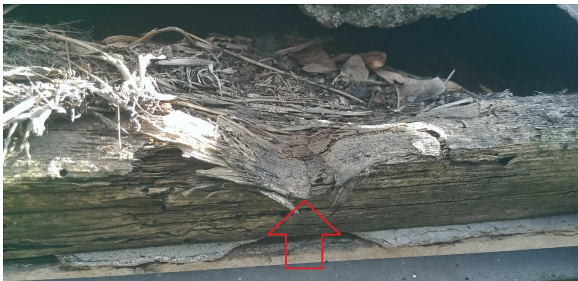
Figuur 3.1. Verzakking in panlat door dakpan, met daarboven uit hooi en stro van de voormalige hooizolder.
