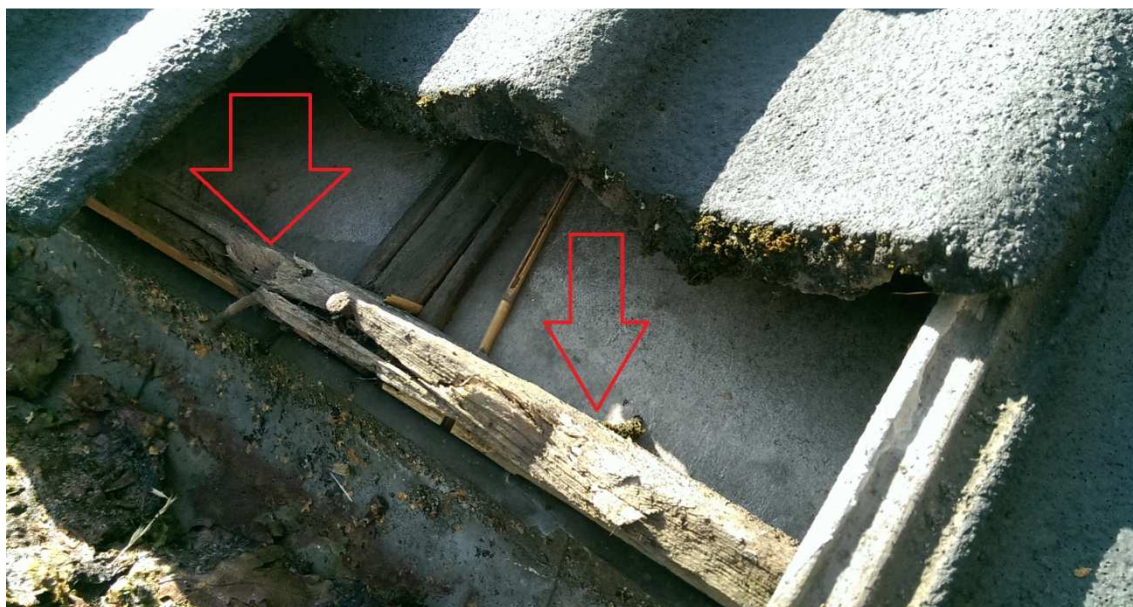
Figuur 3.2. Verzakking in panlat door dakpan aan zuidzijde dak, dakbeschot nagenoeg vrij van organisch materiaal.
