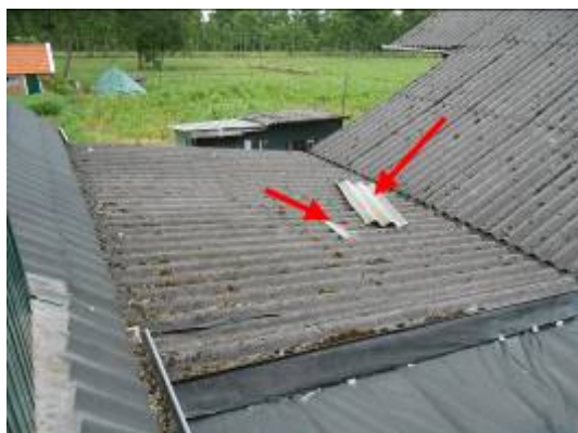
Foto 22 | restanten golfplaat los op dak
