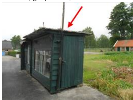
Foto 51 | golfplaten op een del van het dak
