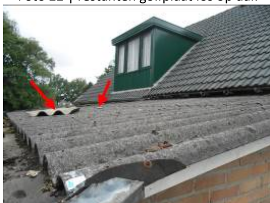
Foto 24 | restanten golfplaat los op dak
