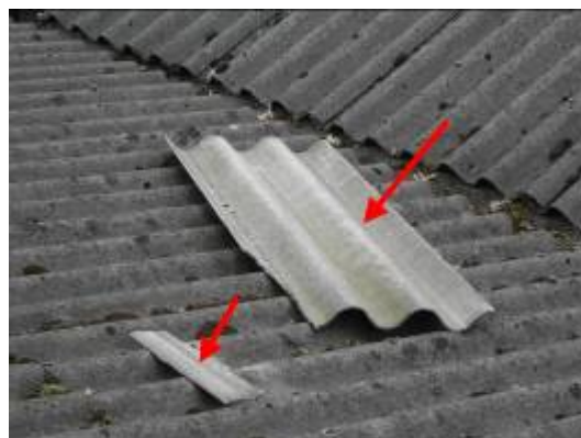
Foto 23 | restanten golfplaat los op dak
