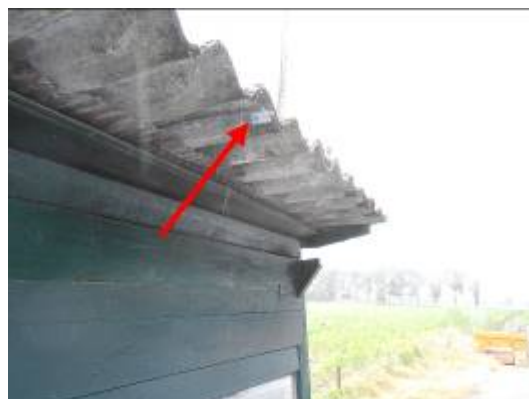
Foto 49 | golfplaten op een del van het dak
