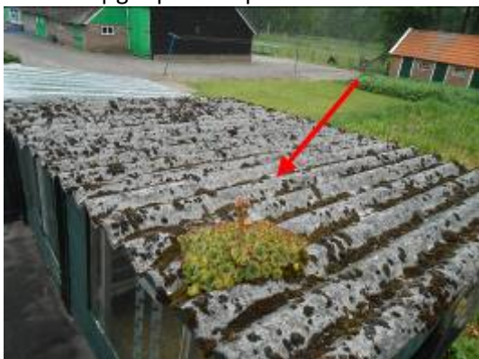
Foto 50 | golfplaten op een del van het dak
