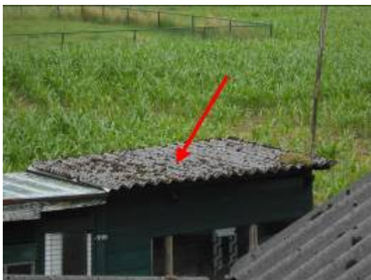
Foto 52 | golfplaten op een del van het dak
