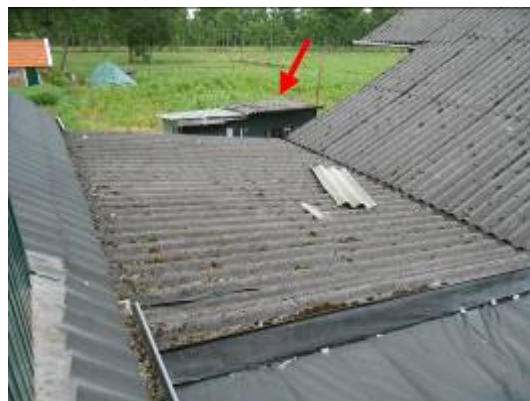
Foto 53 | golfplaten op een del van het dak
