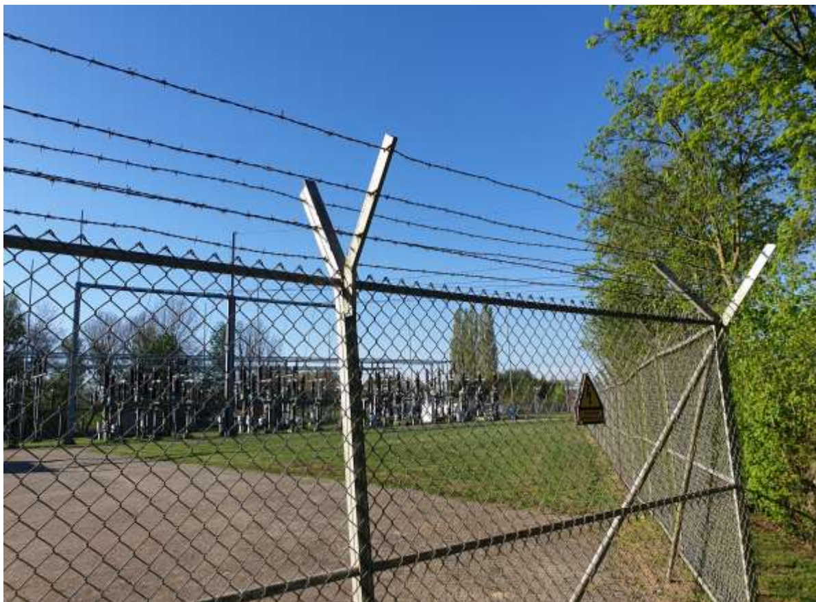
Figuur 1.3 Het 110kV-station, gezien vanuit het zuiden.
