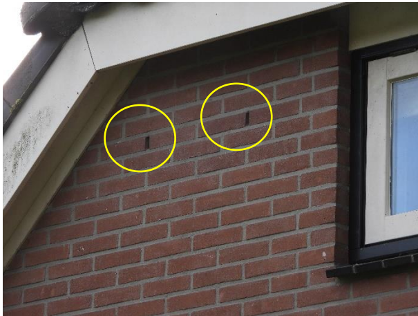
Zichtbare potentiële invliegopeningen in de buitengevel (gele cirkels).
