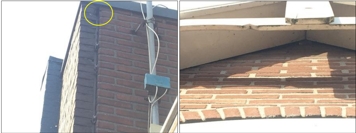
Verbeelding van potentiële invliegopeningen van vleermuizen in het plangebied. Foto links: opening in een dilatatievoeg. Foto rechts: kieren tussen buitengevel en betimmering van het overstek.
