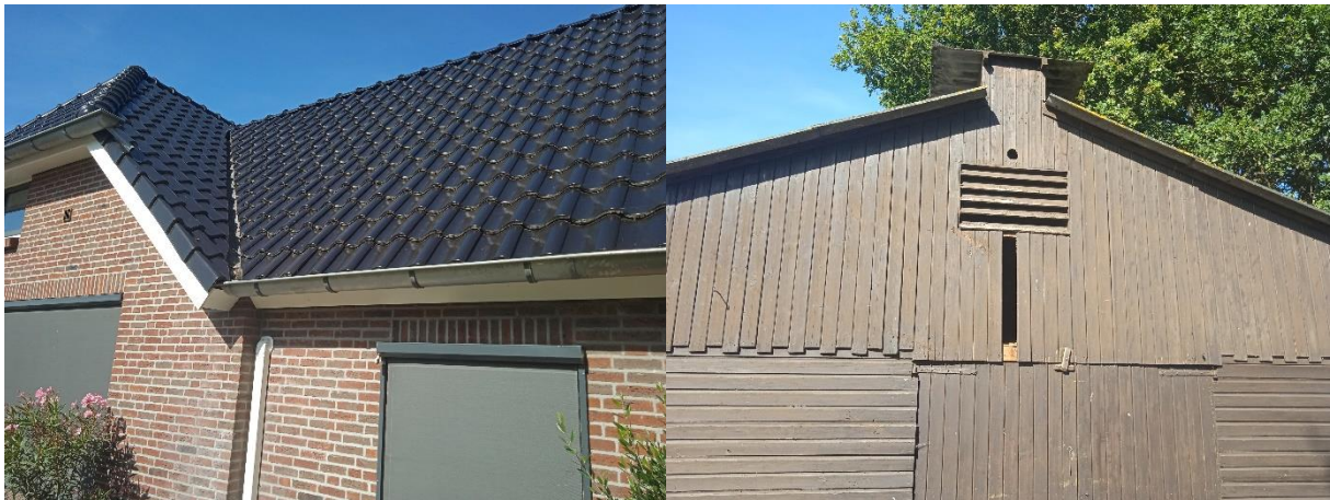
Foto links; de dakpannen van de woning sluiten allemaal strak op elkaar aan. Foto rechts; de noordelijk gelegen schuur is voor vogels toegankelijk.
