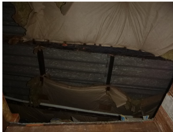
Een gedeelte van het dak (binnenzijde) van toonzaal 1 en opslag van de meubelzaak bestaat uit asbestverdachte golfplaten. Over deze golfplaten is een stalen dak verwerkt.
