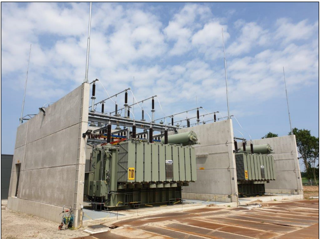
Figuur 2.4: impressie trafocellen.
