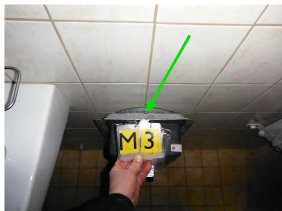
Foto 6: Koord, afdichting M3
