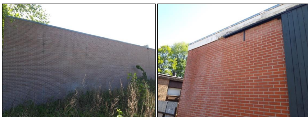
Links de muur met open stootvoegen, rechts de kierende gevelbetimmering.
