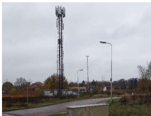
Zendmast met daarachter keten en opslag
