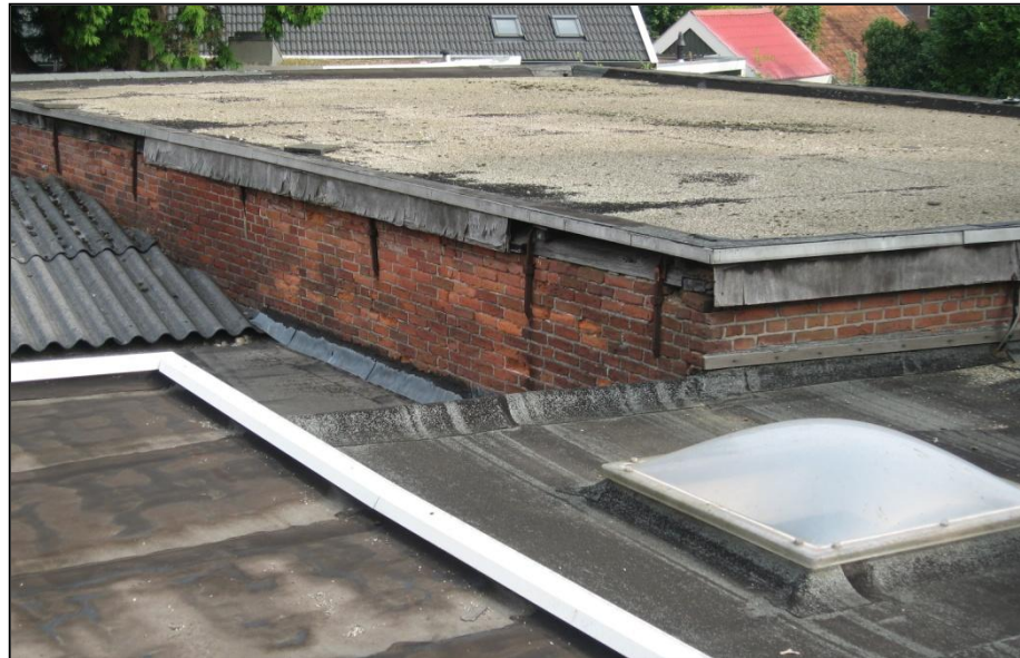
Afbeelding 11 – het magazijn gezien vanaf nevengelegen aanbouwen, vanuit het zuidwesten gezien. Het metselwerk vertoont schade als gevolg van de toegepaste cementmortel als voegmortel. De baksteen is relatief zacht en bevat water, dat door de hardere cementvoeg niet weg kan. Bij vorst ontstaat schade aan de baksteen met kans tot afschilfering van de baksteenhuis.
