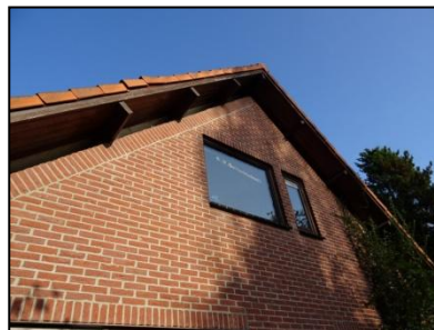
Figuur 4. Overhangende kantpannen en glazen rand tussen dak en (spouw)muur bij gebouw 1.
