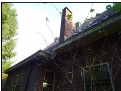
Figuur 6. Gebouw 2 met vervallen betimmering en dak met dakpannen.
