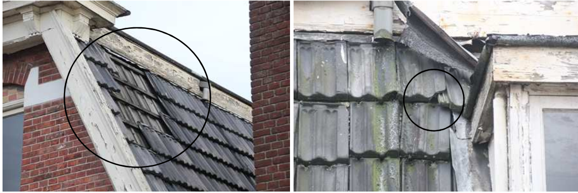
Potentiële invliegopeningen van gierzwaluwen in het gebouw; ontbrekende of kapotte dakpannen.
