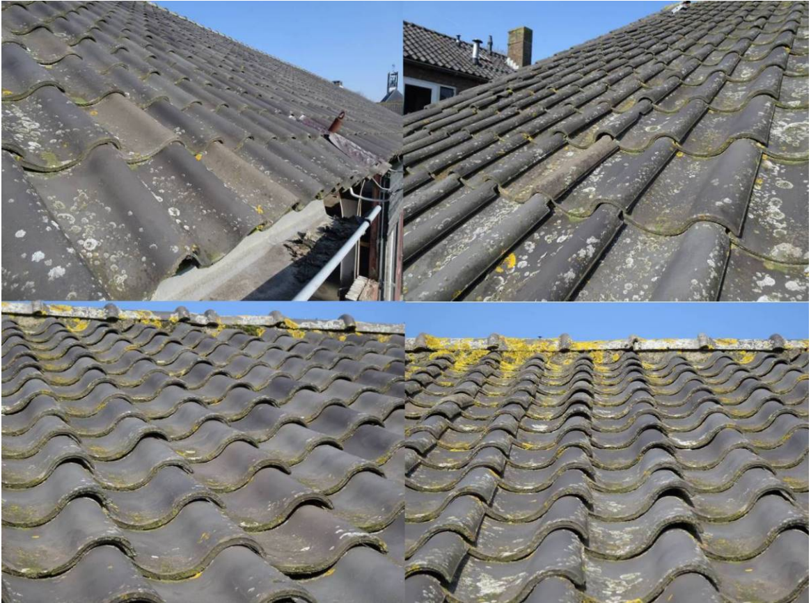
Figuur 4. Volledig ongeschikt dak voor vleermuizen of gierzwaluwen aan de Waterkant 61 te Ens doordat de dakpannen volledig zijn aangesloten en daardoor geen ruimte bieden aan verblijfplaatsen.
