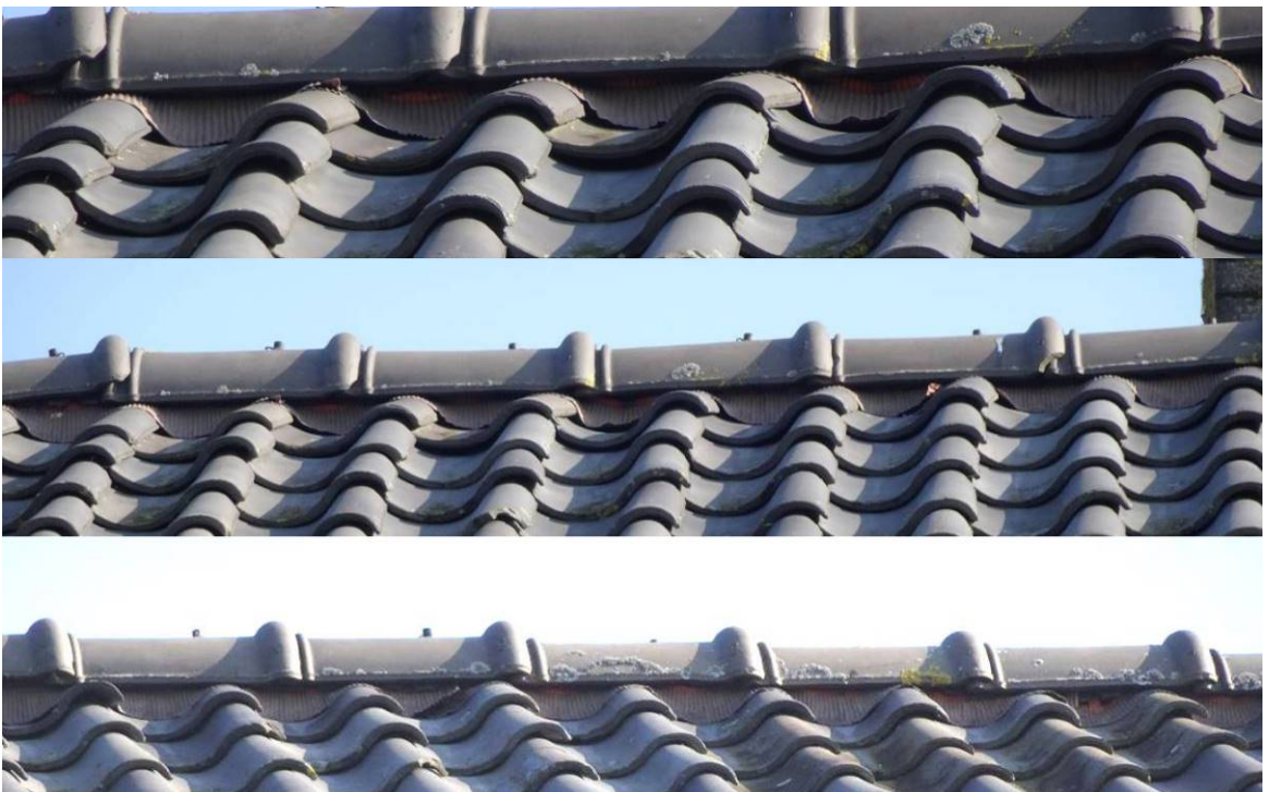
Figuur 5. Dichte dakaansluitingen aan de Waterkant 61 te Ens doordat de dakpannen op de top zijn afgesloten met doek en daardoor geen ruimte bieden aan verblijfplaatsen voor vleermuizen of gierzwaluwen.
