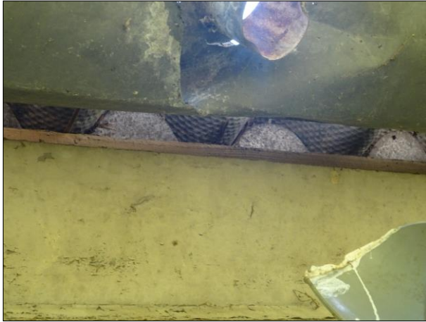
Figuur 4.4 Onderzijde golfplaten gedicht met voegwerk.
