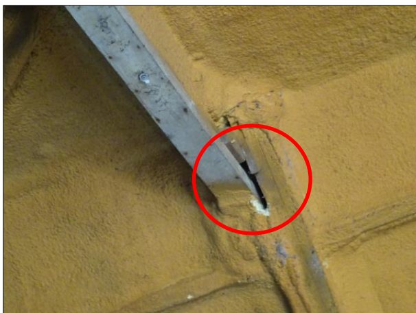
Figuur 4.6 Aanwezige kier tussen isolatieschuim en balkstructuren.
