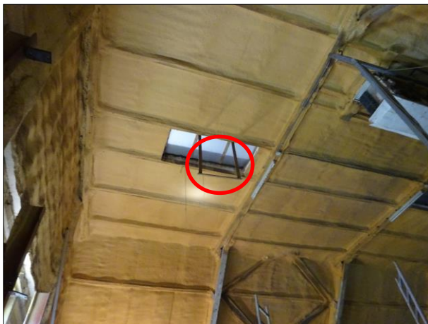
Figuur 4.3. Potentiële roestplaats binnen de schuur.
