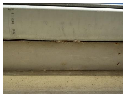
Figuur 13. Dakgoot met rietresten.
