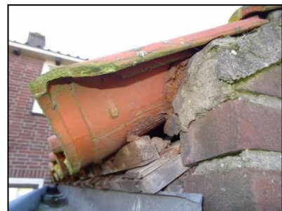
Figuur 19. Opening onder dakpannen woning.
