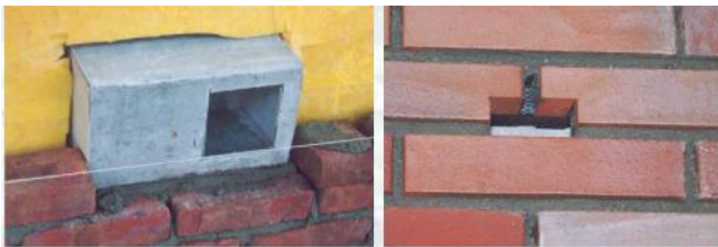
Figuur 19. Onopvallende nestkast voor gierzwaluw. Ingebouwd in de spouwmuur.
