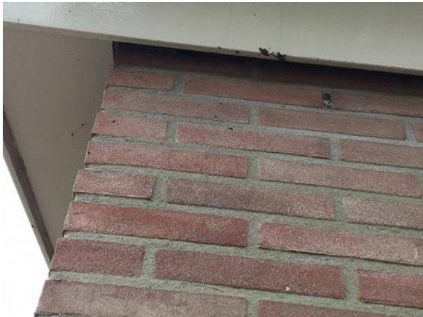
Uitwerpselen van vleermuizen (donkere stipjes) op de muur ter hoogte van de invliegopening.
