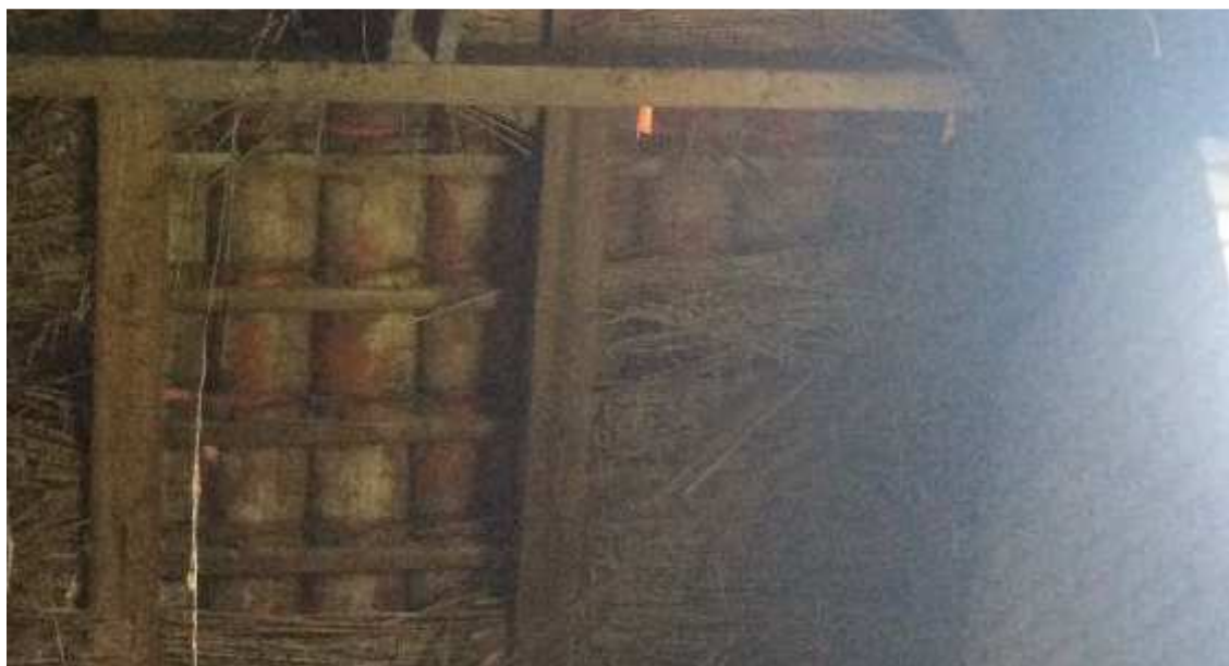
Fig. 5.1. Binnenzijde boerderij, met vervallen rietbedekking tegen dakpannen.
