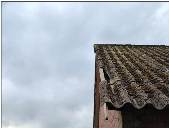
Foto: Gat in de dakbedekking varkensstal.
