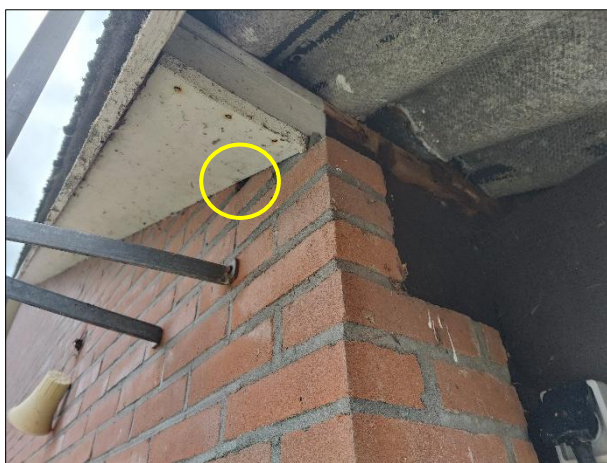
Foto: gaten in de gevel onder de dakoverstek.
