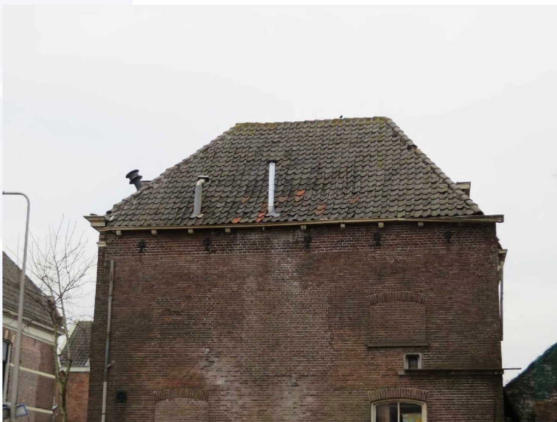
Foto 4. Een zijaanzicht van het pand. aan deze zijde zijn ook veel openingen/kieren bij het dak.
