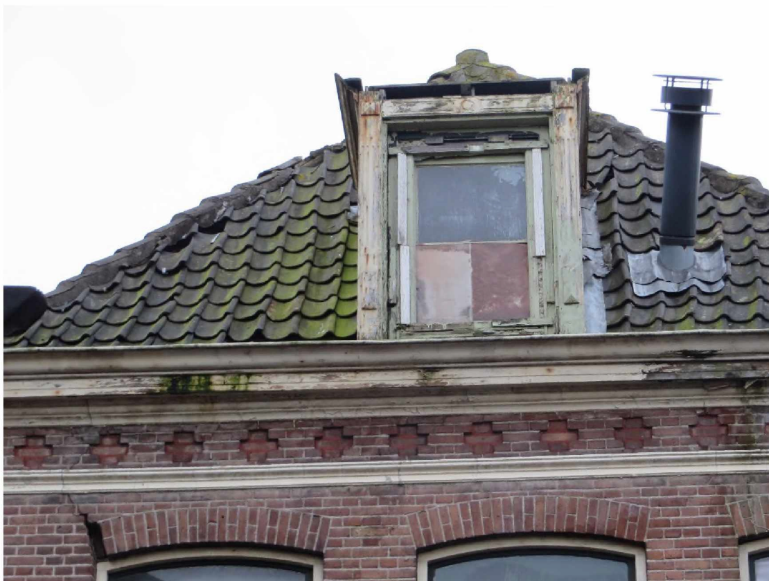
Foto 3. Veel kieren en grotere openingen aan voorzijde dak.
