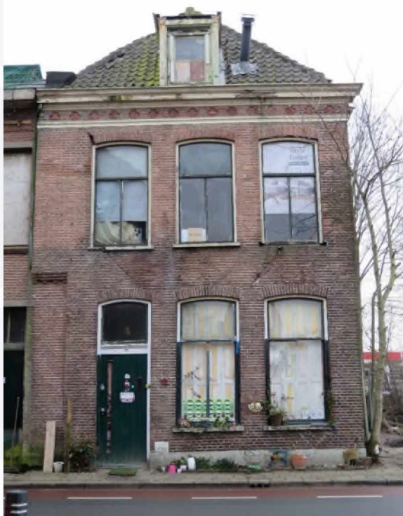
Foto 2. Vooraanzicht. Veel kieren en gaten te zien in de muur en het dak.
