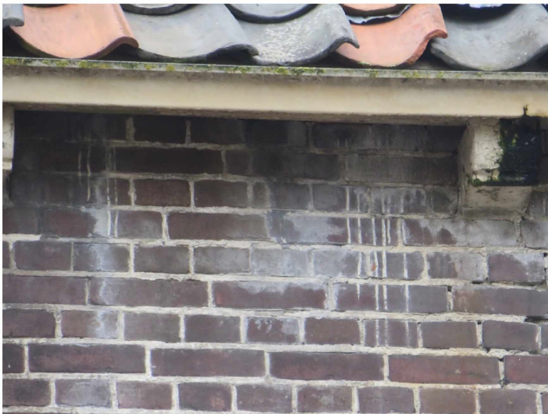
Foto 5. Zijkant van het pand. Oude sporen van huiszwaluwnesten.
