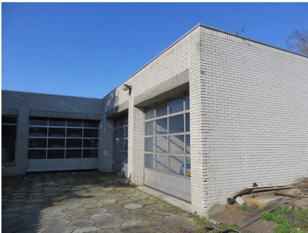
Foto 9. Achterzijde van IJsseldijk 2-I. Er zijn geen stootvoegen aanwezig. Wel zijn er kieren bij de daklijst.
