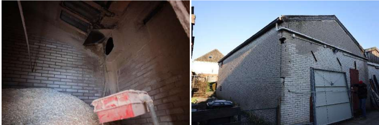
Figuur 7 Details van het krullenhok (Deel 3). Het binnenklimaat (links) in deze ruimte is niet geschikt voor welk dier dan ook door de enorme hoeveelheid stofdeeltjes. Er zijn geen sporen van bewoning door dieren aangetroffen. De dakgoot aan de buitenzijde van dit pand (rechts) biedt door de nauwe ingang geen potenties voor huismussennesten. Foto's Bureau Biota.
