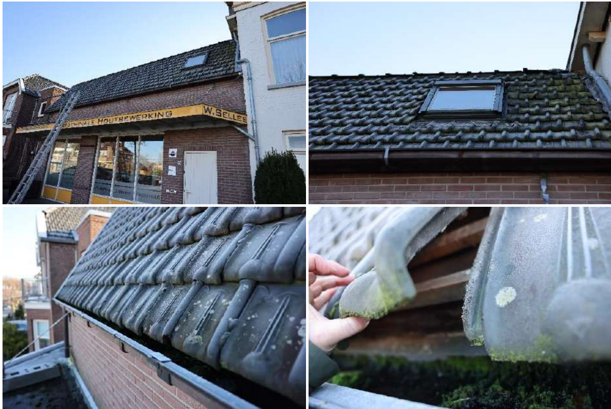
Figuur 5 Detailopname van het pand gekenmerkt als Deel 1, ter hoogte van de dakgoot. Dit is het enige pand dan verwarmd wordt. De nauwe toegang tussen dakgoot en dakpannen, het vrij steile dak alsmede het platte karakter van de toegepaste dakpannen, maken dat hier zeer waarschijnlijk geen huismussen onder het pannendak kunnen geraken. Foto's Bureau Biota.
