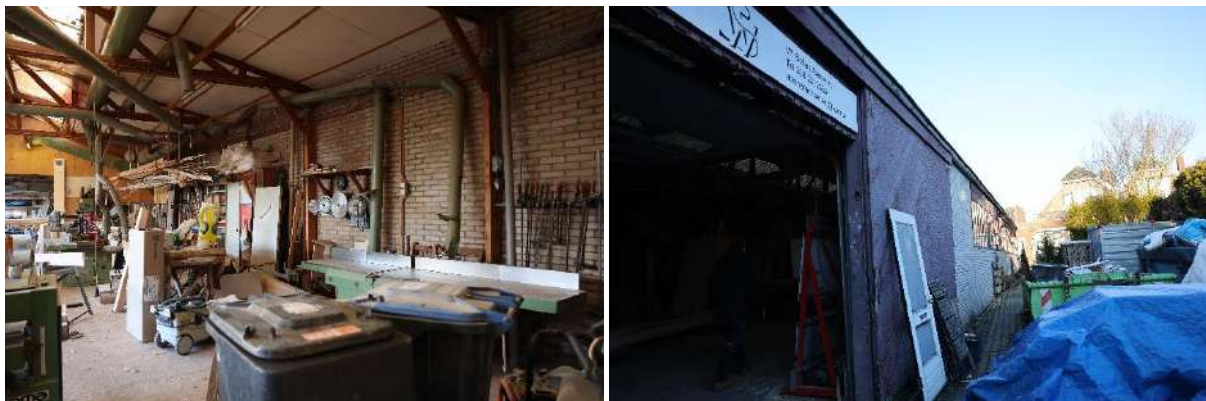
Figuur 6 Detailopname van het pand gekenmerkt als Deel 2, gezien van uit de binnenzijde (links) en vanaf de buitengevel aan de oostzijde. Dit pand wordt niet verwarmd, bevat een smalle dakgoot richting een tochtige loods. Dit zijn niet de omstandigheden waar men nesten van huismussen zal verwachten, zeker niet nu de zagerij nog in gebruik is. Daarnaast is de binnenzijde van deze loods nagelopen op sporen van vogelnesten, maar er is niets aangetroffen. Foto's Bureau Biota.
