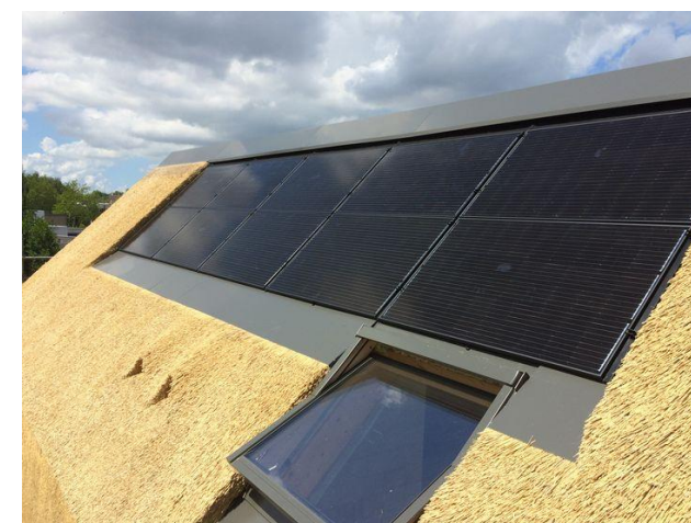
referenties zonnepanelen in het dak
