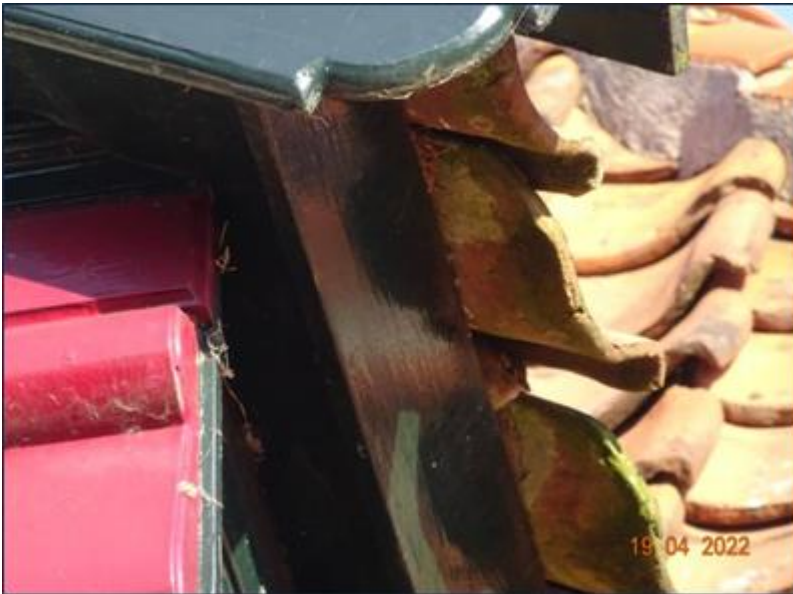
Afbeelding 7 Locatie nest onder dakpannen.
