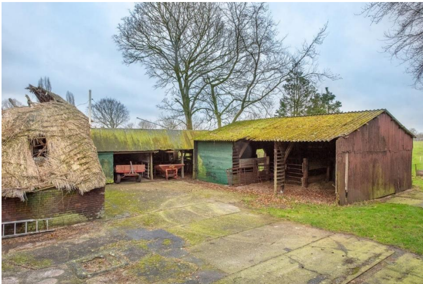
Afbeelding: Bestaande schuren die in slechte staat verkeren.
