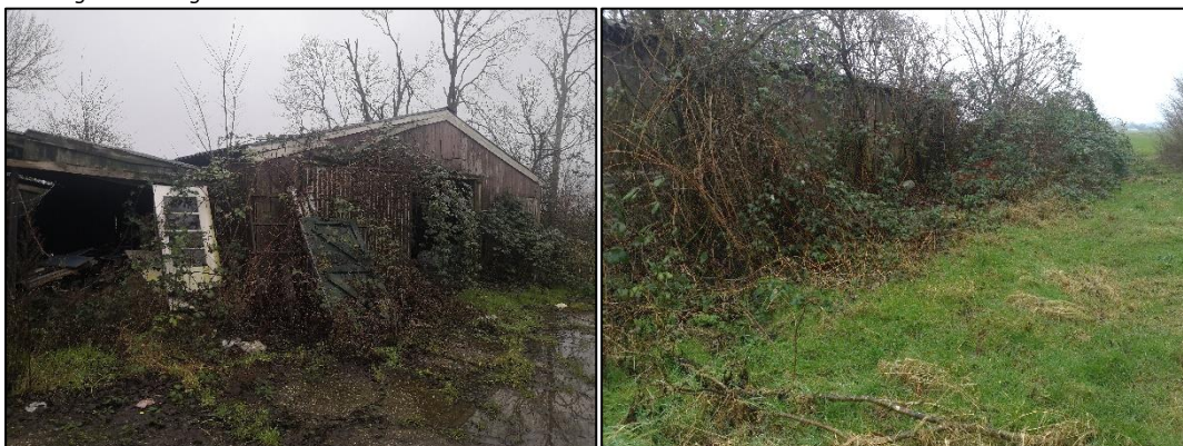
Figuur 2.5 (links): Vooraanzicht van de hooiberg, gebouwd van hout met golfplaten dakbedekking. Delen van de hooiberg zijn ingestort. In en rond de hooiberg liggen puinhopen en oude bouwmaterialen; Figuur 2.6 (rechts): Zij aanzicht van de hooiberg met aangrenzende heesters en bramenstruiken. Tussen de struiken liggen een aantal buizen en andere oude bouwmaterialen.
