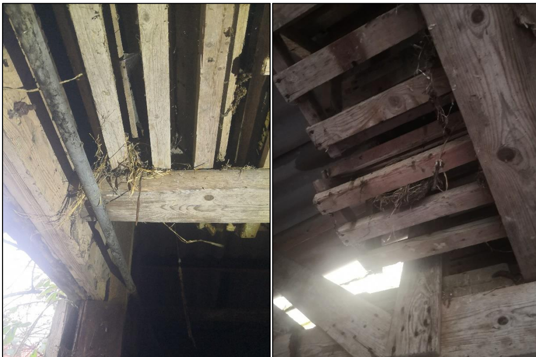
Figuur 2.11 en 2.12: Meerdere oude vogelnesten in de schuren, deze zijn door de gehele betimmering aangetroffen.
